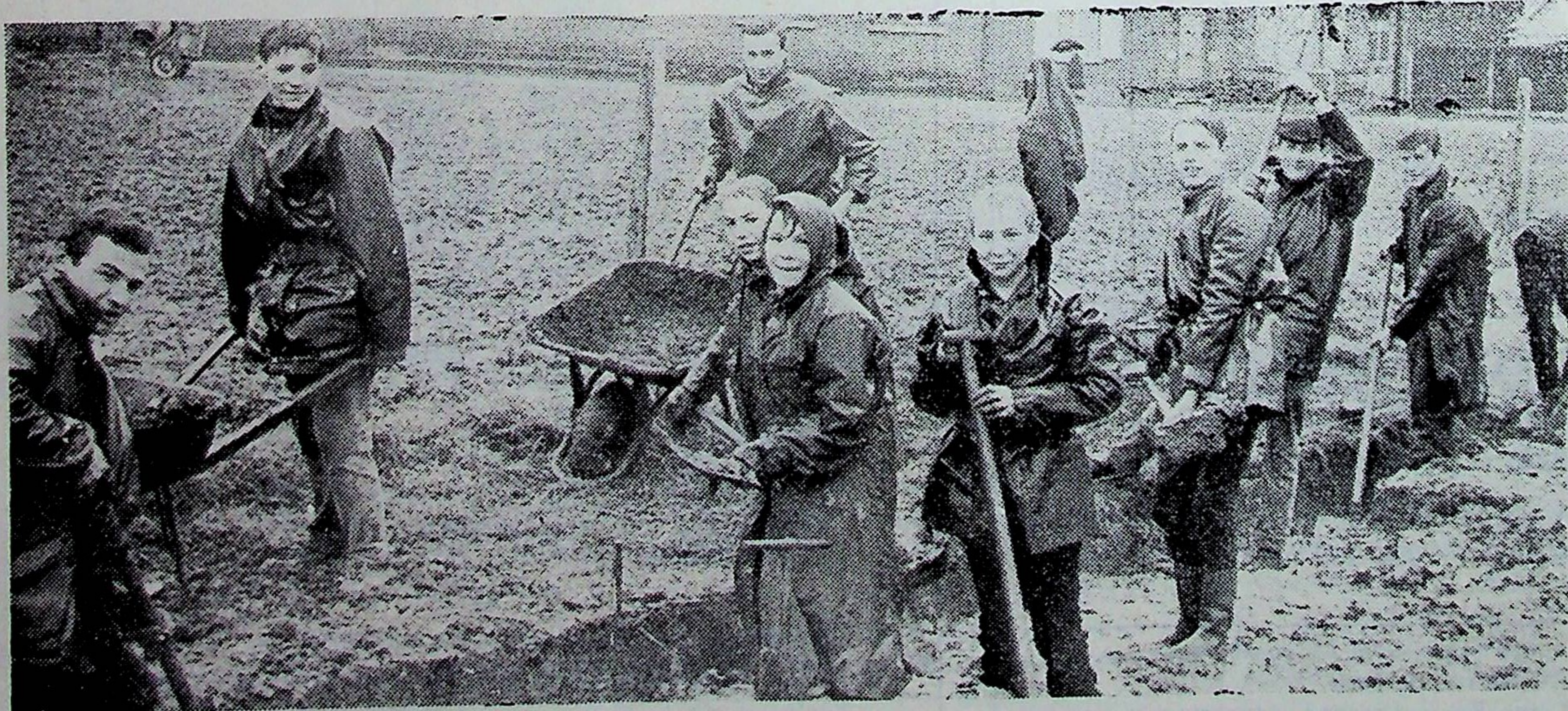
Le terrassement n'est pas de tout repos, mais la bonne humeur est de rigueur. Cliché Nord Eclair, La Croix du Nord.
